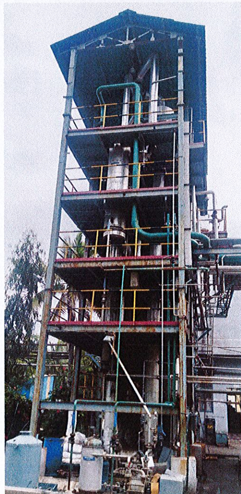
Fig. Effluent Treatment Plant (ETP)
